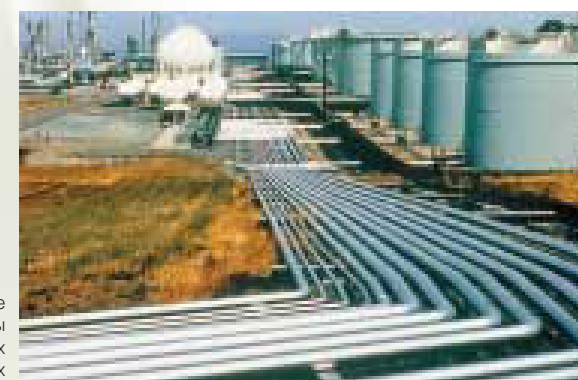
Защита от замерзания, поддержание технологической температуры и обогрев на НПЗ, химических и нефтехимических предприятиях
